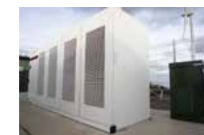
4MW蓄電池(左) 蓄電池制御システム(右)
