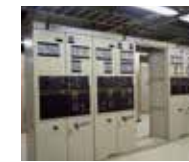
縮小型監視制御盤
