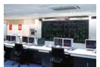
集中監視制御システム
