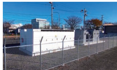
ミツウロコ宮城県仙台蓄電所
