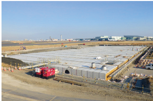
東京国際空港地下貯留施設
