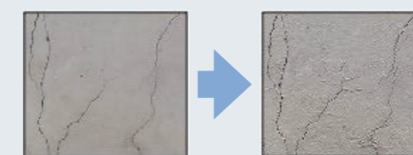
VIS処理によるコンクリートのひび割れの強調表示
