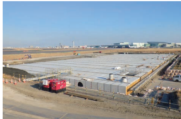
東京国際空港地下貯留施設
