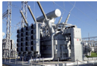
6号変圧器(275kV/154kV、450MVA)
