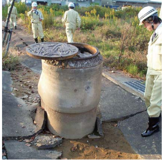
液状化現象によって地上に突き出したマンホールは下水機能を破壊するだけでなく、救急車や作業車両などの交通の障害となり、復旧を妨げる
