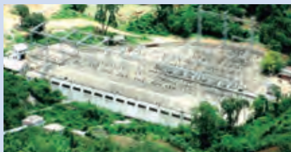
ビルマ バレーチャン水力発電事業
