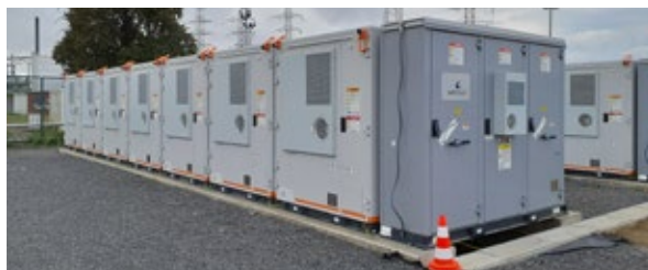
ベルギーRuien蓄電所
