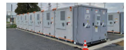
ベルギー-Ruilen蓄電所
