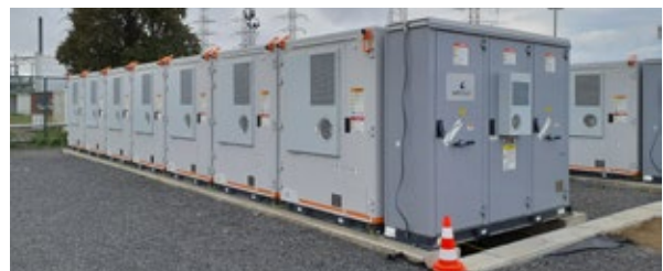
ベルギーRuien蓄電所
