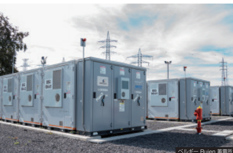
ベルギー Ruien 蓄電所
