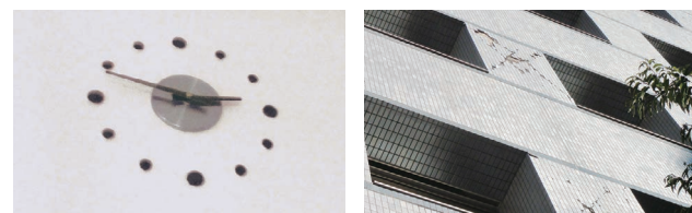
左/東日本大震災が発生した時間で止まったオフィスの時計 右/オフィスビルの外壁が剥落した跡
