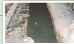
揺れに耐えられるよう、基礎には鉄骨を打ち込み、コンクリートでしっかり基礎固め。
