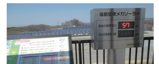
現在の発電電力を表示する当社システム
