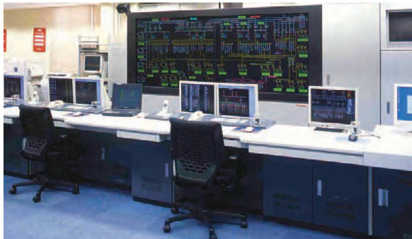
変電所集中監視制御システム
