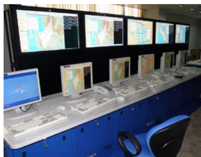
本事業で導入された洪水予警報システム監視装置
