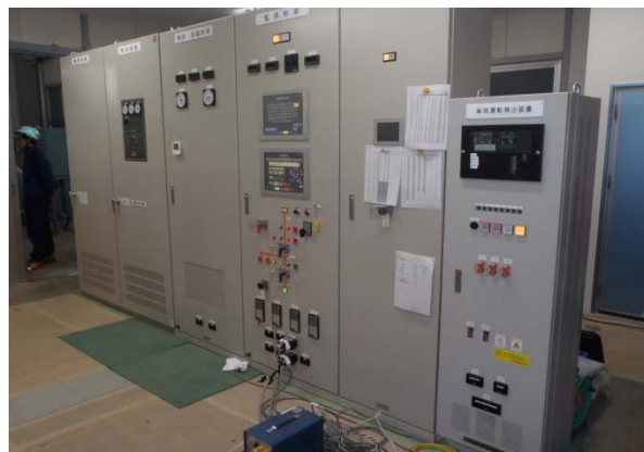
制御装置外観
