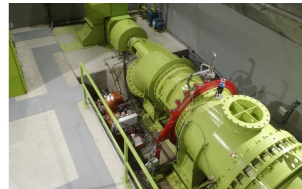
白滝発電所更新
