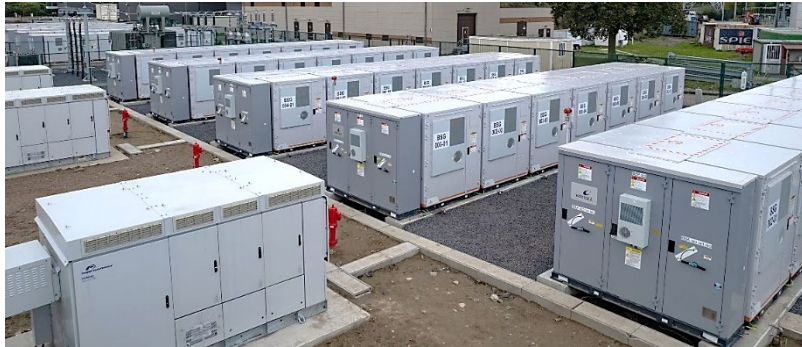
ベルギーRuien蓄電所
