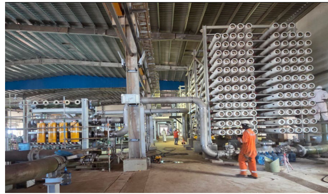
RO（逆浸透：海水から塩分を除去する膜処理技術）棟内部
