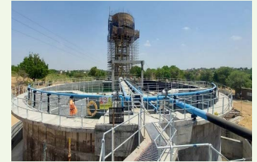
下水処理場の関連施設の一部
